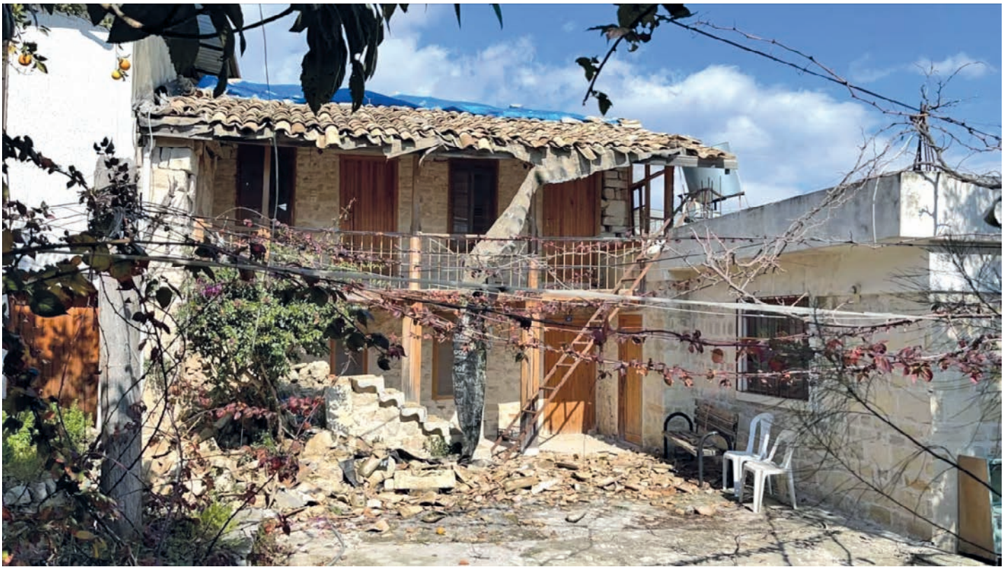
Le village de Vakıfköy a été fortement endommagé par le dernier tremblement de terre en Turquie de l'Est
